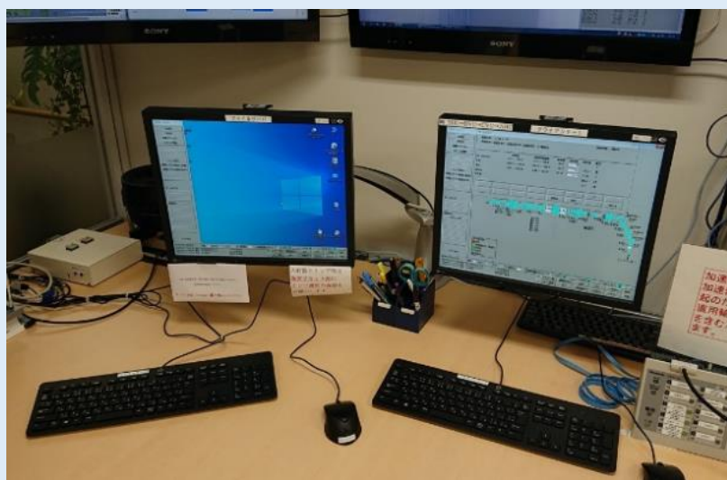
更新された制御計算機(一部)の画面
